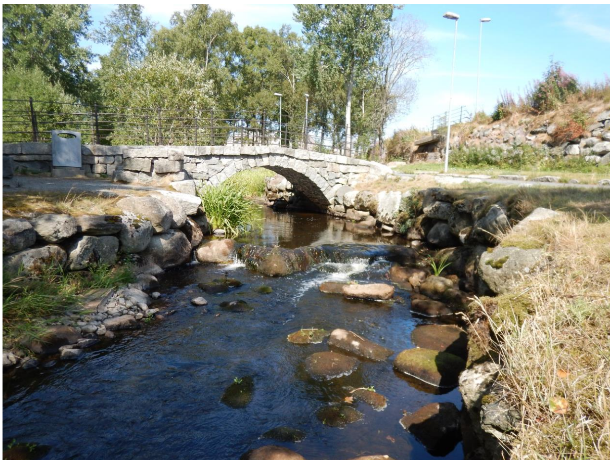
Figur 2.5. Steinterskelen nedstrøms brua ved samfunnshuset på Kverneland utgjør trolig et vandringshinder ved små vannføringer.
